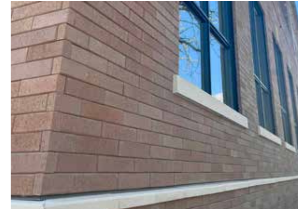
INTÉGRATION TRANSPARENTE» Heritage Dry-Stack, Prairie
